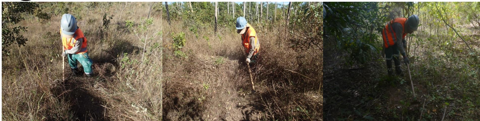
FIG. 11, FIG. 12 E FIG. 13. LIMPEZA INICIAL DAS SUPERFÍCIES NAS ÁREAS DE INTERVENÇÃO, PONTOS CP_54_74, CP_33_48 E CP_12_34 (FOTOS: CLEICIANE NOLETO E JAQUELINE BELLETTI).
