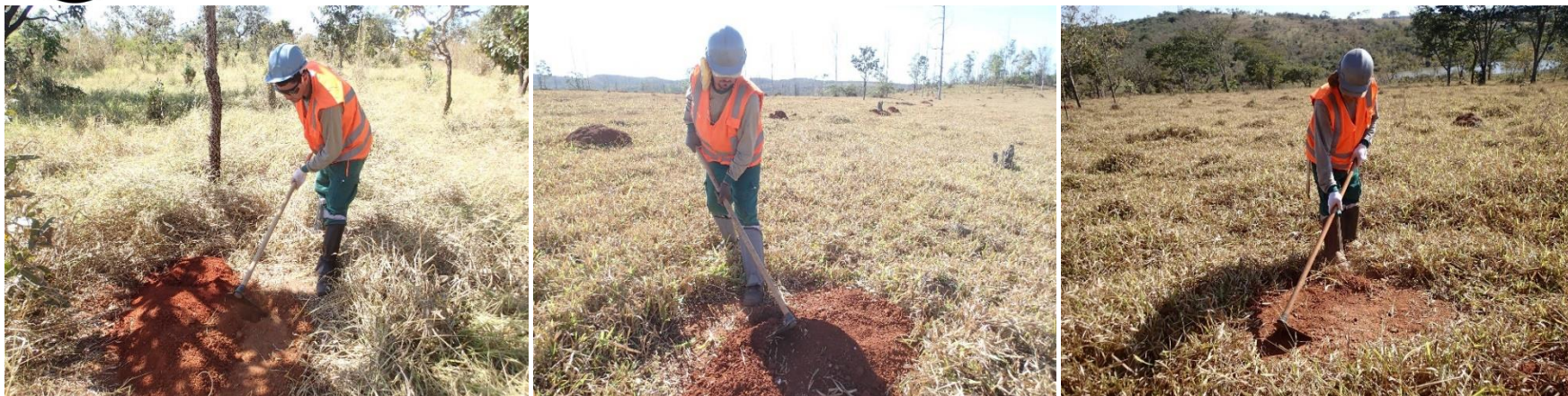
FIG. 75, FIG. 76 E FIG. 77. FECHAMENTO DAS INTERVENÇÕES, PONTO CMC_19_57, CMC_27_24 E CMC_14_17 (FOTOS: CLEICIANE NOLETO E RENATA ESTEVAM).
