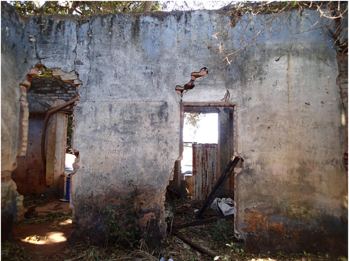
FIG. 110. DEPREDÇÃO DAS PAREDES (FOTO: RENATA ESTEVAM).
