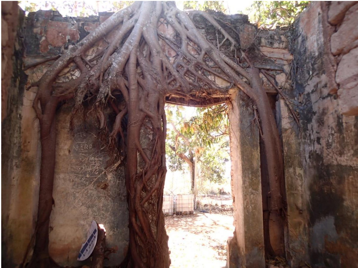
FIG. 111. CRESCIMENTO DA RAIZ D A ÁRVORE SOBRE A PAREDE E DEPREDAÇÕES NAS PAREDES. (FOTO: RENATA ESTEVAM).
